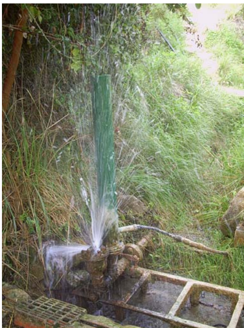
Bomba de impulsión (Punto 5 de la fig. 11) (Jorge Jiménez Sánchez)
